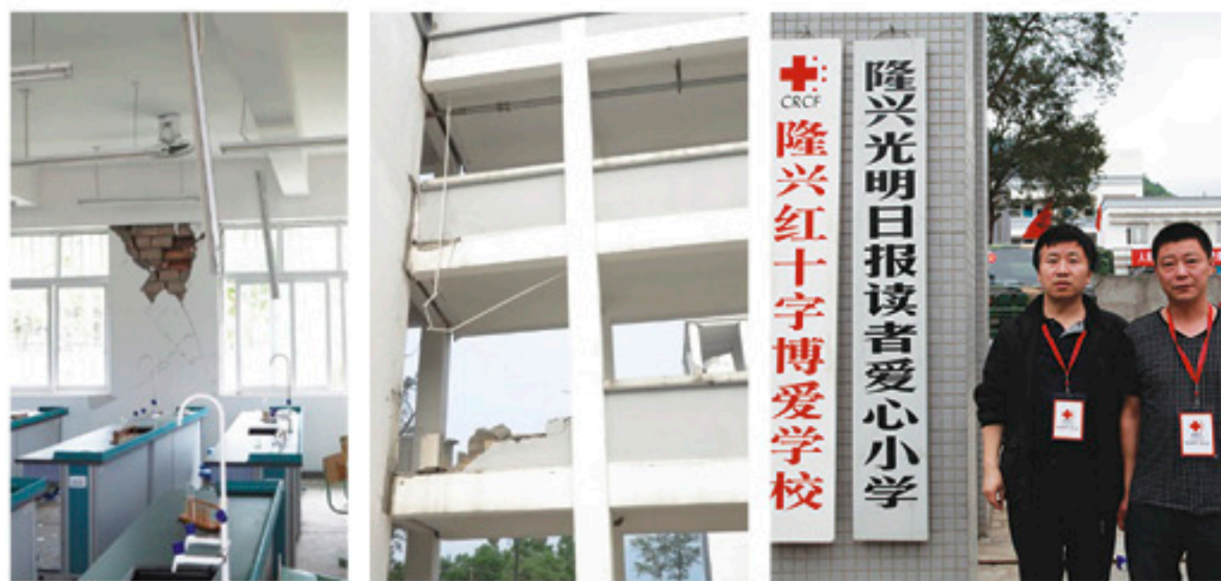
芦山县隆兴中心小学震后情况
